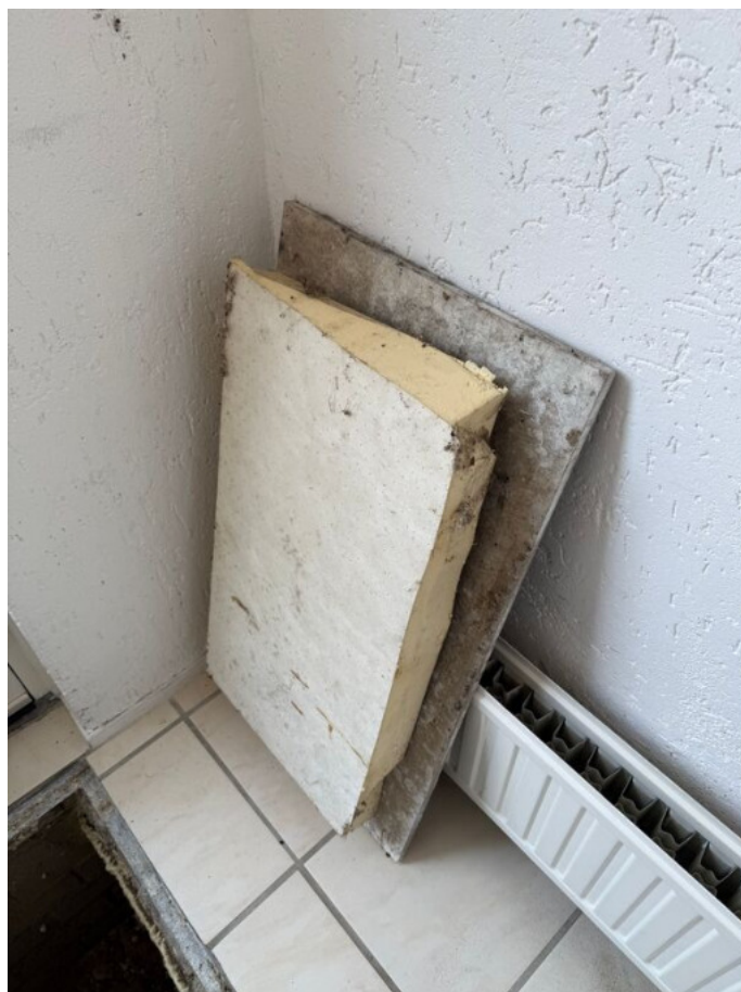
Asbestverdacht luik kruipruimte
