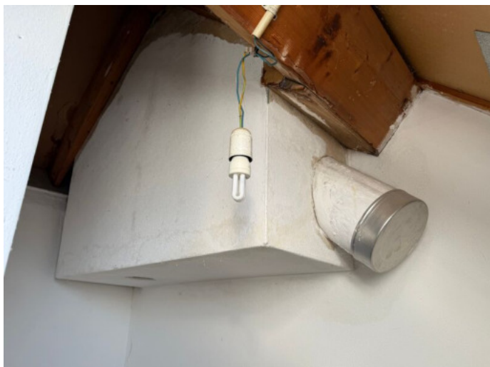
Asbestverdachte pijp zolder
