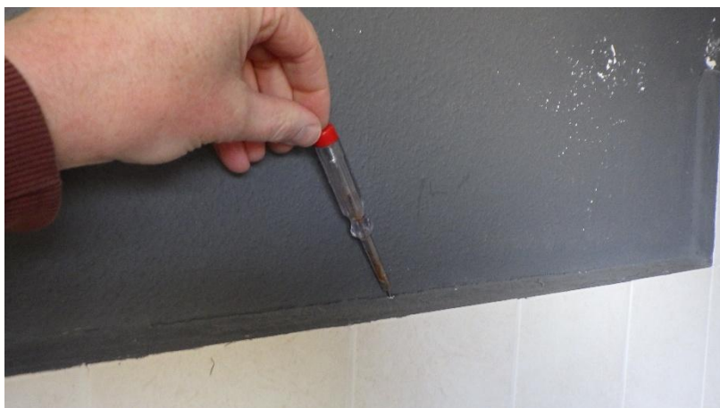
Foto 03: Badkamer; Het tegelwerk is overlaagd. Tussen de lagen tegelwerk is plaatselijk ruimte aanwezig.
