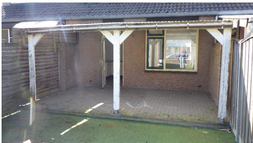
Foto 07: Overkapping achterzijde; Het houtwerk is vergaan. De overkapping heeft zijn einde levensduur bereikt.
