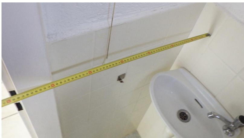
Foto 06: Toilet; De toiletruimte is beperkt.
