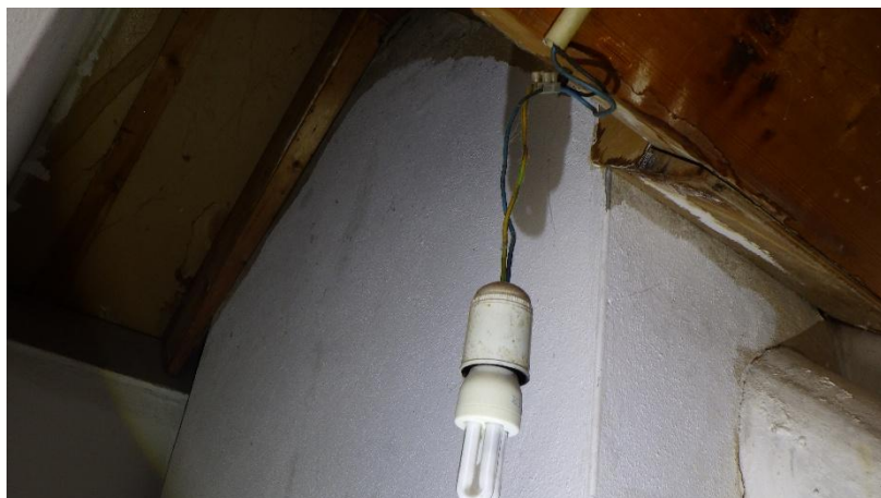
Foto 01: Onderzijde hellend dak; Rondom de schoorsteen zijn enkele sporen van doortrekkend vocht zichtbaar.
