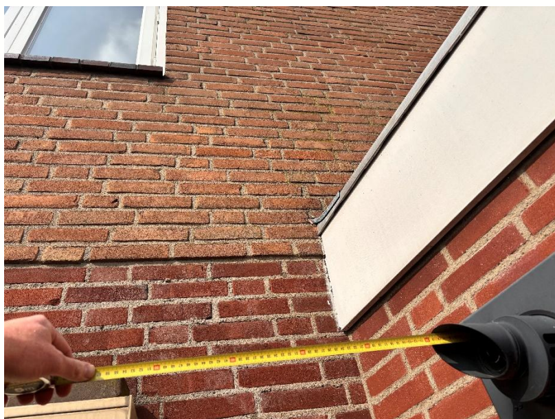
Foto 07: Voorgevel; De rookgasafvoer van de c.v. installatie welke behoort tot het belendende perceel is onder een raamkozijn gesitueerd.
