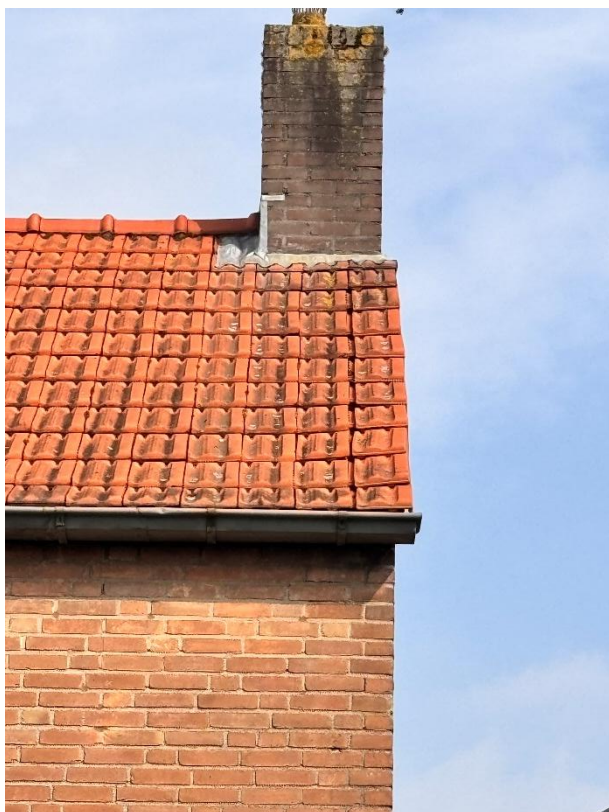
Foto 08: Dakvlak voorzijde; De pannen liggen plaatselijk onregelmatig. De schoorstenen dienen op termijn onderhouden te worden.
