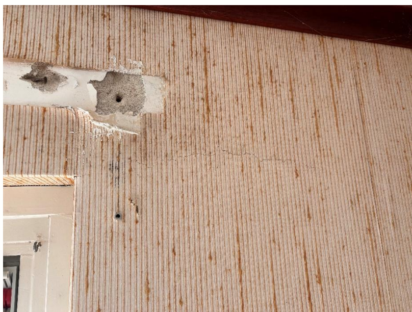
Foto 02: Slaapkamers; Op de gehele verdieping zijn (lichte) scheurvorming aanwezig.
