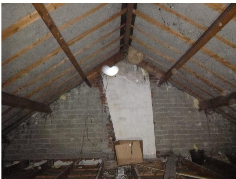
Foto 01: Onderzijde hellende dak: Op diverse locaties zijn (restanten) van wespennesten zichtbaar.
