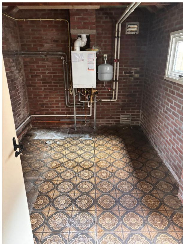
Foto 06: Bijkeuken; De wanden zijn halfsteens. De dakconstructie (en vloerbedekking) zijn asbest verdacht.
