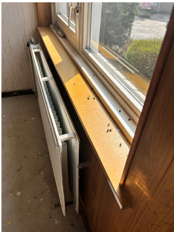
Foto 03: Slaapkamer voorzijde rechts: De aanwezige vensterbanken zijn vervaardigd middels asbest verdacht materiaal (vermoedelijk ook de geschilderde vensterbanken).
