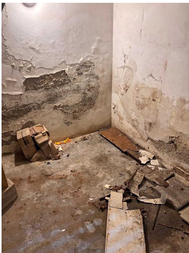
Foto 05: Kelder; De wanden en vloer vertonen sporen van doortrekkend vocht.
